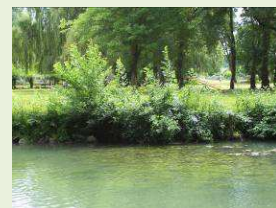
❗ Portion de berge végétalisée : une solution efficace, naturelle, esthétique, et économique pour consolider les berges
