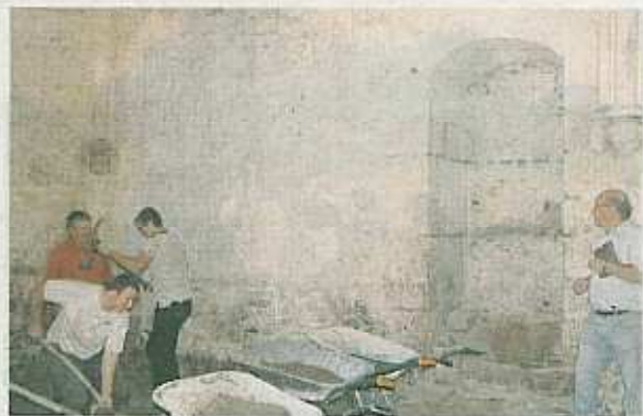
Les bénévoles déblaient une épaisseur de terre d'environ 50 cm pour retrouver le niveau du carrelage. A droite, la porte d'accès d'origine : elle sera rouverte.
